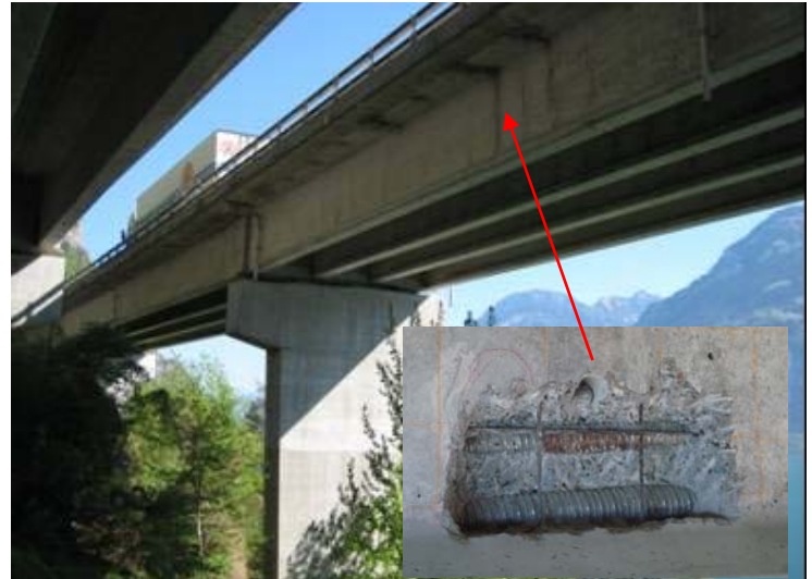
Abb. 1: A2 Viadukt Bolzbach Nord. Korrosion an Spanngliedern im äusseren Längsträger unterhalb von tropfenden Belagsentwässerungsröhrchen
