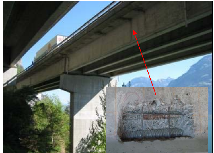
Fig. 1: A2 viaduc Bolzbach Nord. Corrosion aux unités de précontrainte sur la poutre extérieure, sous les pipettes
