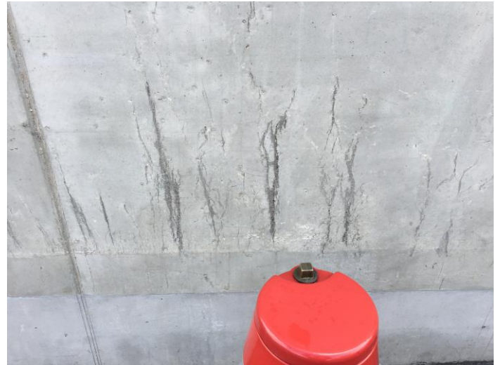
Abb 1: Schleppwassereffekte (dunkle, vertikale Linien) durch blutenden (wasserabsondernden) Beton
