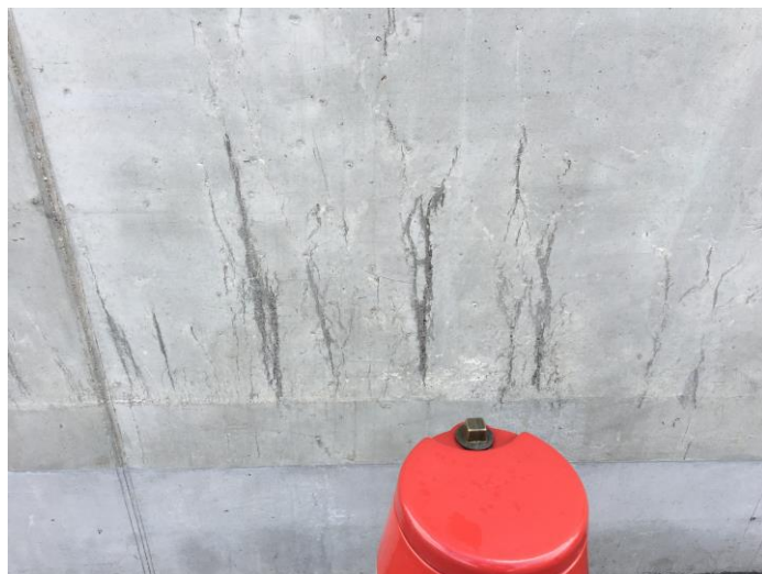
Fig. 1 : traces de ressuage (lignes sombres, verticales), ségrégation du béton
