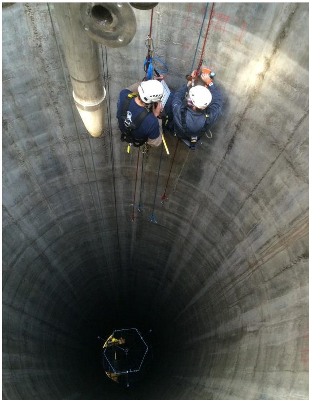
Abb. 2: Radarmessungen – Ortung der Leerrohre und der Bewehrung in einem 90m hohen Kamin (Kronfink GmbH)
