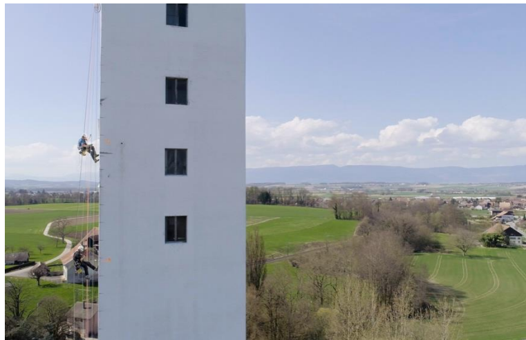
Abb. 4: Zustandsuntersuchung nach Brandfall an einem 55 m hohen Getreidesilo (Five Element Production Särl)
