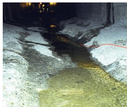
Sohle eines Geschiebeumleitstollens mit sehr starkem mechanischen Angriff
