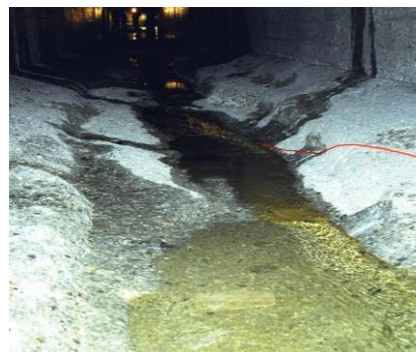
Radier d'une galerie de dérivation charriant des sédiments et présentant une forte abrasion
