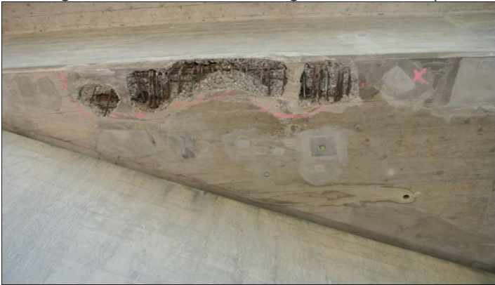
Abb. 6: Abplatzungen über engliegender Bewehrung
