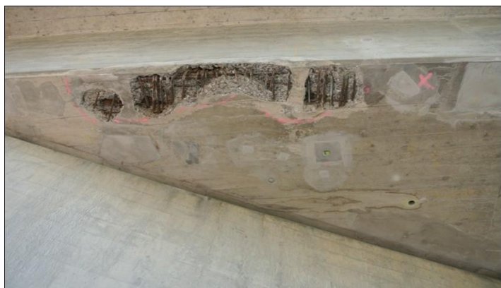
Fig. 6: Eclatements en-dessous d'une armature très dense
