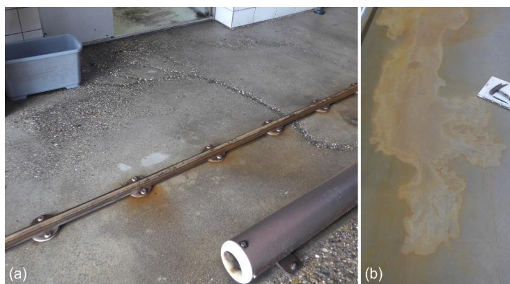
Fig. 3 : exemples de sols industriels détériorés : (a) attaque dissolvante par détergents dans station de lavage pour camions ; (b) taches dues à une fuite d'acide de batterie.
