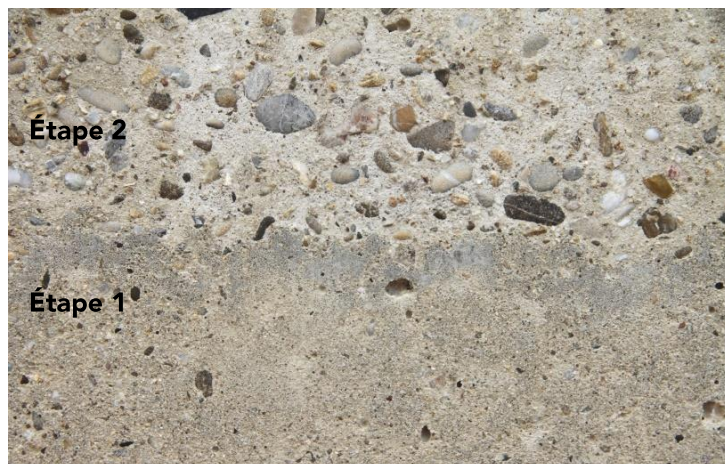
Fig. 1 : effritement d'une paroi de piscine sous l'action de l'eau : deux étapes de bétonnage avec sensibilité différente aux attaques. (Largeur de la photo 20 cm)
