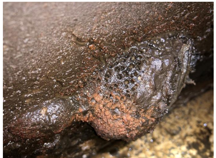
Abb.2: Knollenbildung aus Korrosionsprodukten am Wandfuss unter «Wasser»
