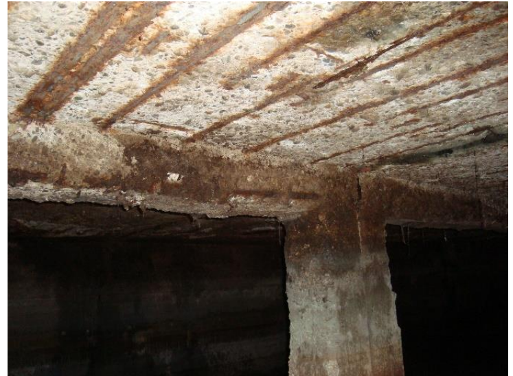
Abb. 1: Beton- und Stahlkorrosion im Luftraum über der Gülle
