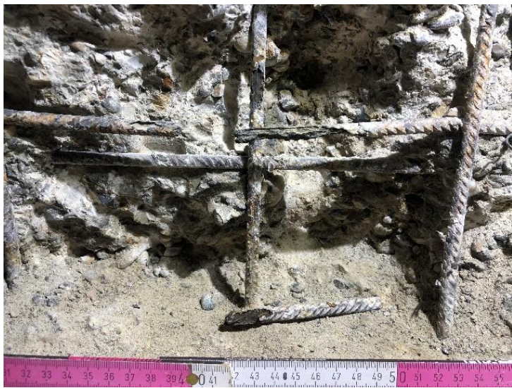
Abb.3: Starke Bewehrungskorrosion am Wandfuss nach rund sechs Jahren Betrieb (Sondage bei Abb.2)
