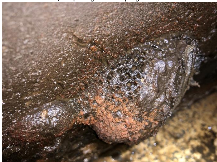
Fig.2 : Formation d'une « excroissance » de corrosion au pied de paroi immergée
