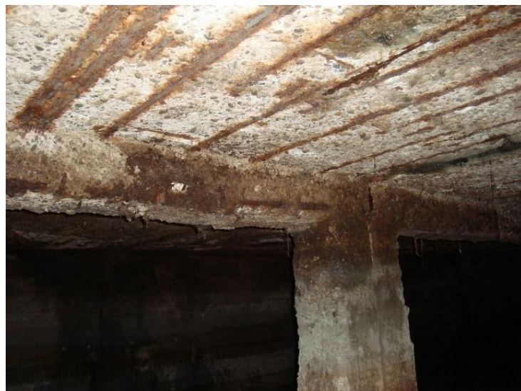
Fig. 1 : Corrosion du béton et de l'armature dans l'espace aérien au-dessus du lisier
