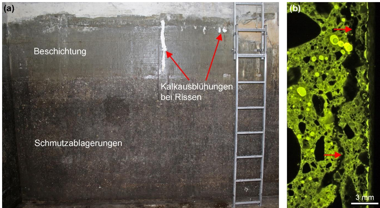
Abb. 2: (a) Beschichtete Beckenwand eines Regenüberlaufbeckens mit Ablagerungen und Kalkausblühungen bei Rissen. (b) Mikroskopische Aufnahme einer unbeschichteten, ausgelaugten Regenüberlaufbeckenwand: Absanden der Betonoberfläche und Bildung einer inneren Kalkschicht (rote Pfeile) im Randbeton.
