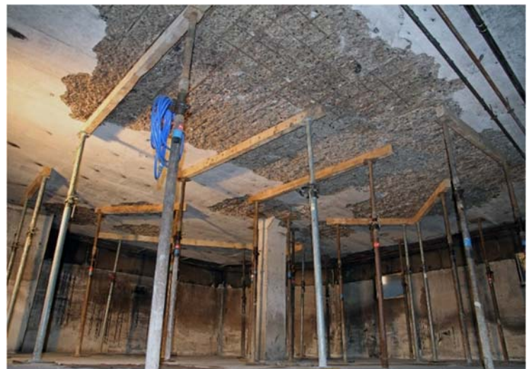
Abb. 1: Abplatzungen und freiliegende, durchgebogene Bewehrung an einer Wand und der Deckenuntersicht in einem Werkhof (oben) und Decken-Abplatzungen nach einem Autobrand in einer Garage (unten).
