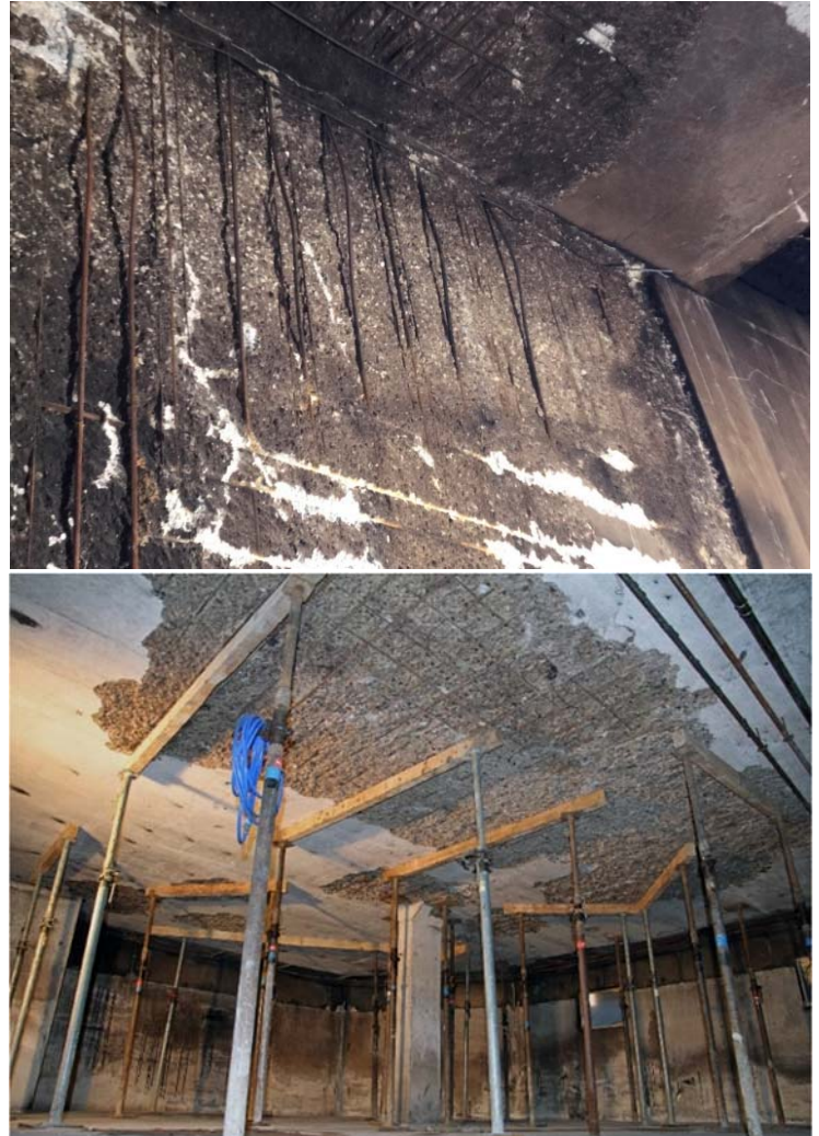
Fig. 1: Eclatement du béton et armature mise à nu et fléchie sur un mur et en intrados d'une dalle dans un atelier (en haut) et éclatement du béton au plafond après un incendie de voiture dans un garage (en bas).
