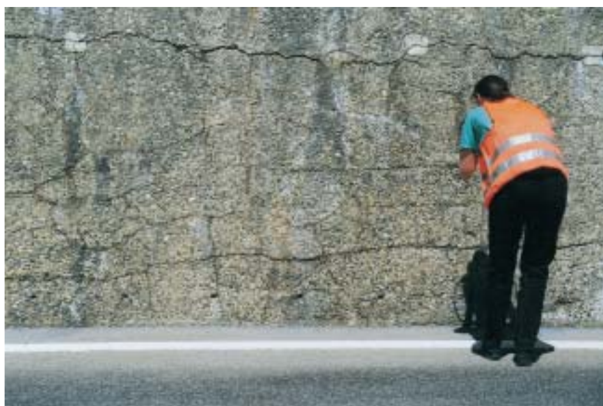
Dégâts dus aux RAG dans un mur de soutènement non armé.
