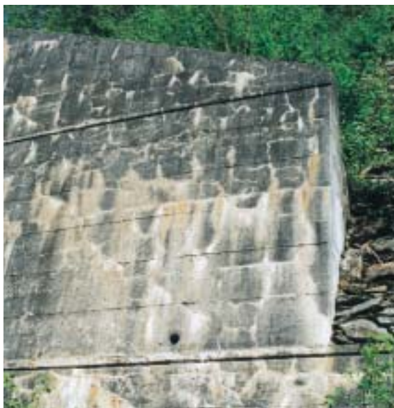
Fig. 2 Superposition de fissures dues à la RAG, à la corrosion et à des contraintes statiques, avec dépôts calcaires.
