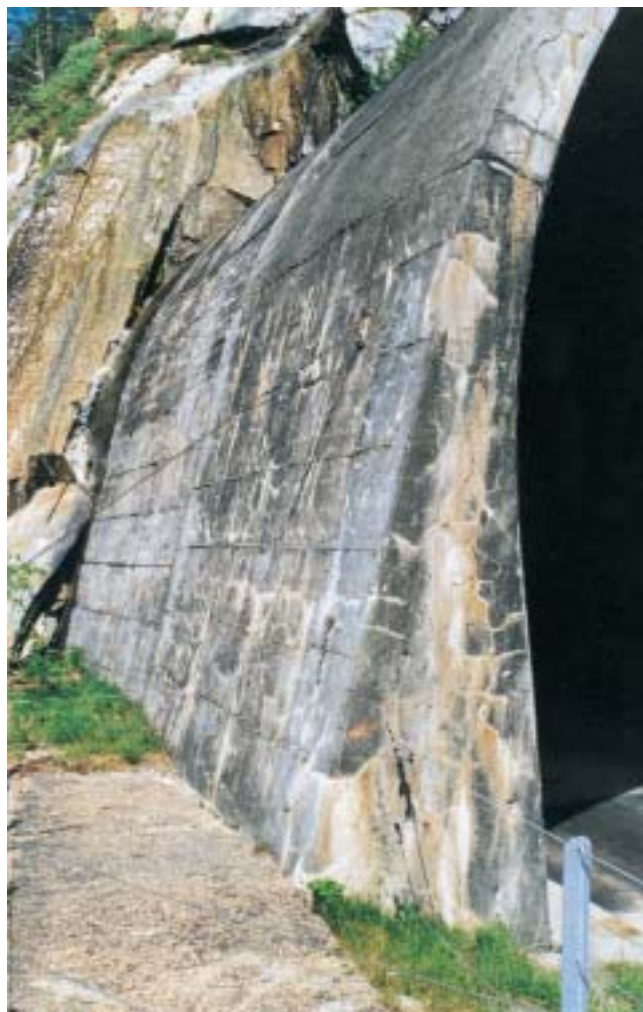
Fig. 5 Superposition de fissures dues à la RAG, à la corrosion et à des contraintes statiques, avec dépôts calcaires.
