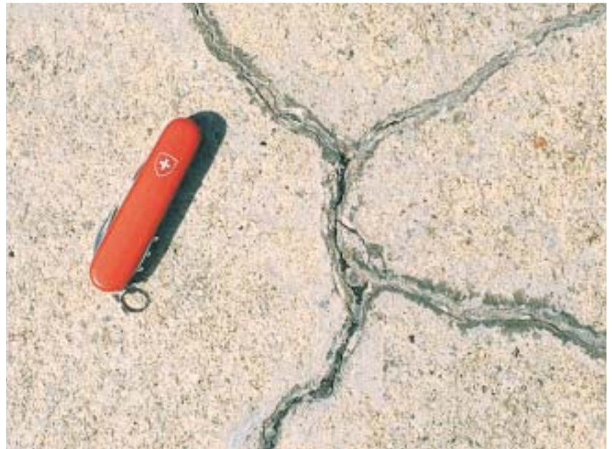
Abb. 6 AAR-Schaden in Krone von Staumauer. Die Risse enthalten (dunkles) Kieselgel.
