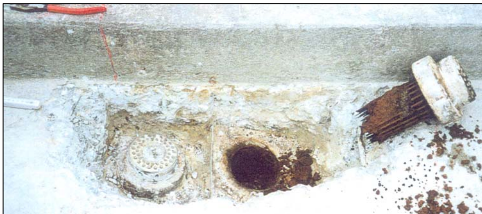
Bild 2.28 Ankerkopf einer Strebenverankerung in der Fahrbahnplatte unter einem undichten Belag (GR-23).
