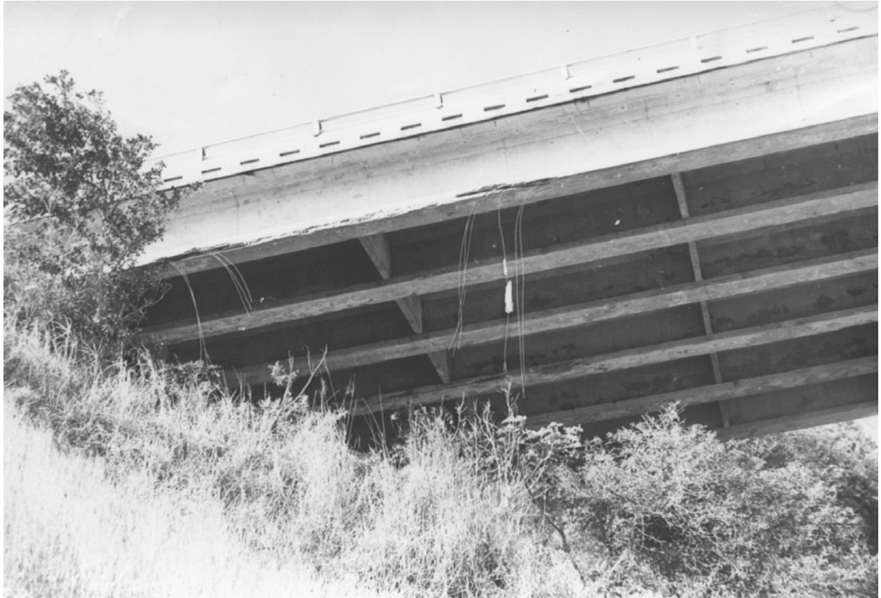
Bild 2.68 Wegen Korrosion gerissene Litzen der Bacunayagua-Brücke in Kuba [PIARC 1999].
