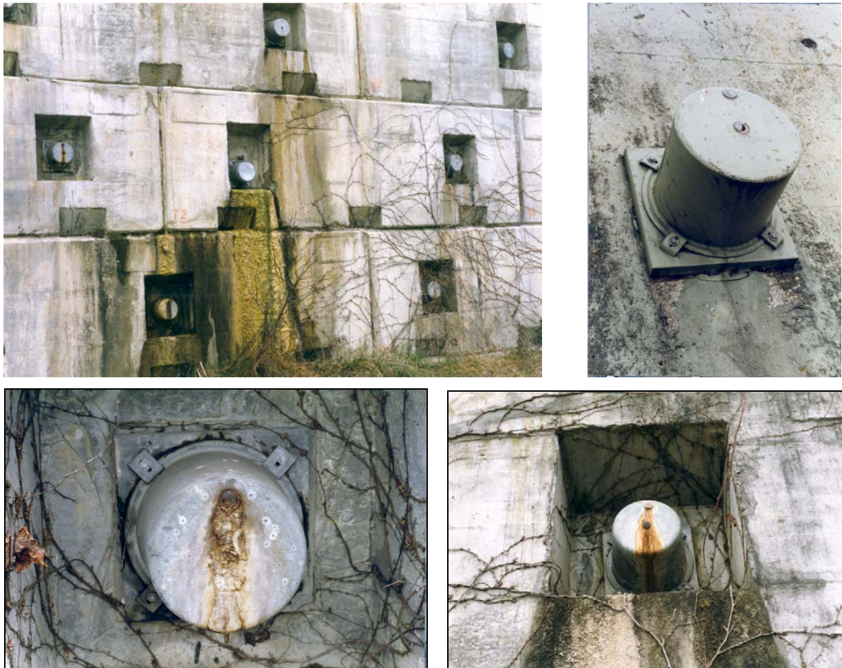
Bild 4.12 Wasserlauf aus dem Ankerkopfbereich bzw. aus der Ankerhaube und defekte Kunststoffdeckel in der Ankerhaube ( OW-01 ).
