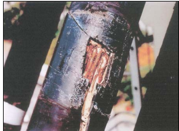
Bild 5: Risse im PE-Hüllrohr sowie Drähte mit Korrosionsspuren (verursacht von Kerben einer unvorteilhaften Inspektionsöffnung).
