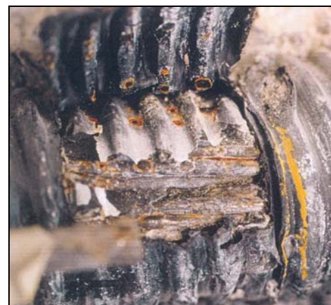
Bild 5: Korrosion am Spannstahl bei einem Hochpunkt.
