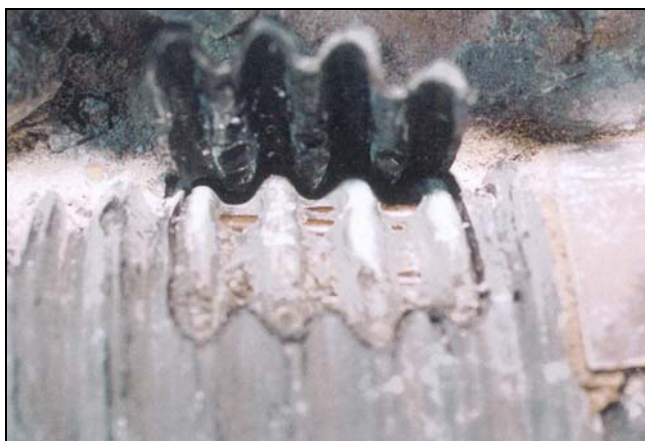
Bild 4: Litzen sind im Tiefpunkt an die Hüllrohrwand gepresst worden (keine alkalische Einbettung).
