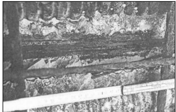
Bild 3: Durchkorrodiertes Hüllrohr und durchkorrodierte Spanndrähte.
