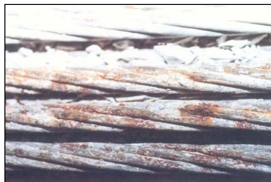
Bild 5: Korrosion an den Spannlitzen.
