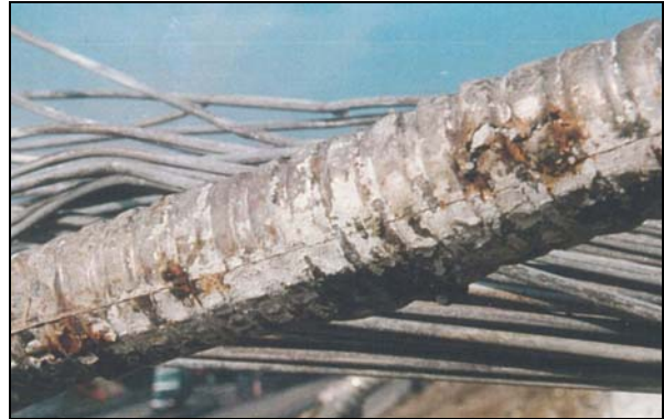
Bild 4: Korrosionsangriff an der Seite.
