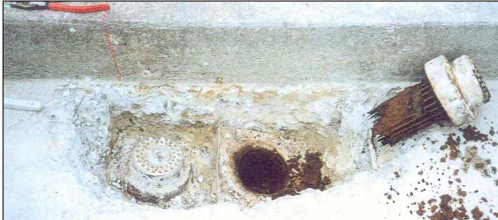
Bild 3: Ankerkopf mit durchkorrodierten Drähten.
