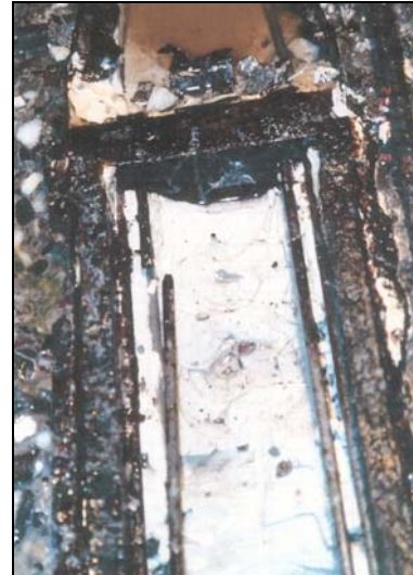
Bild 7: Freigelegter Z-Anker mit Drahtbruch
