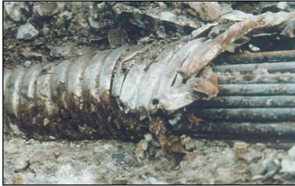
Bild 3: Korrosionsangriff an Unterseite.
