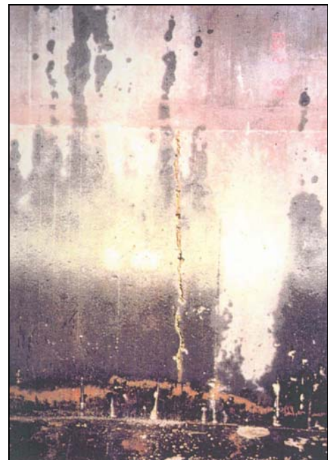
Bild 2: Riss in der Behälterwand.
