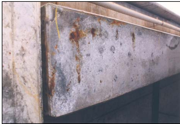
Bild 5: Korrosionsspuren am Trägeranfang (Untersicht eines Trägerunterflansches).
