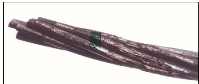
Bild 5: Noch nicht gebrochenes Litzenende auf der „intakten“ Seite: Starker Materialabtrag vor dem Stauchkopf.
