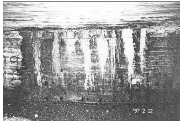
Bild 5: Wassereintritt durch Elektrorohre.
