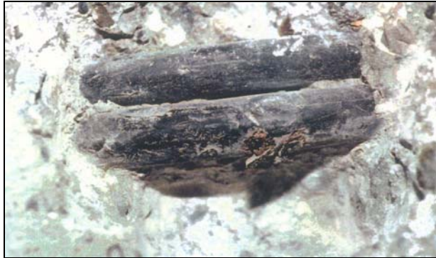
Bild 3: Beschädigtes Hüllrohr an der Stelle eines „Fettflecks“.
