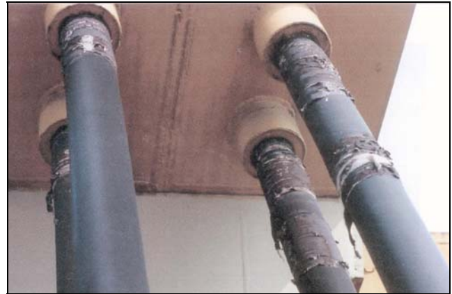
Bild 3: Muffenbereich oben (mit versprödeten Bandagen).
