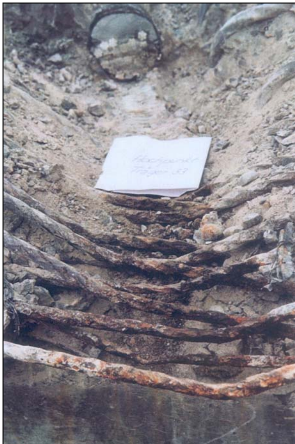
Bild 3: Bewehrung unter einem deformierten Hüllrohr.
