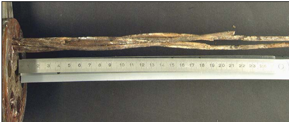
Bild 11: Litze des Normalankers; Spannkopf und Litze mit braunen, Litze streckenweise mit weiss-braunen Korrosionsprodukten bedeckt.
