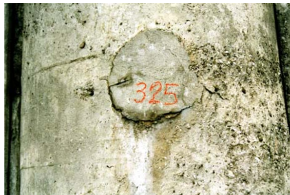
Bild 2: Feuchter und gerissener Nischenbeton.
