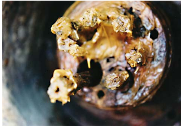
Bild 6: Kontrollankerkopf mit gebrochener und entkeilter Litze. Die Keile lagen in der Schutzhaube.
