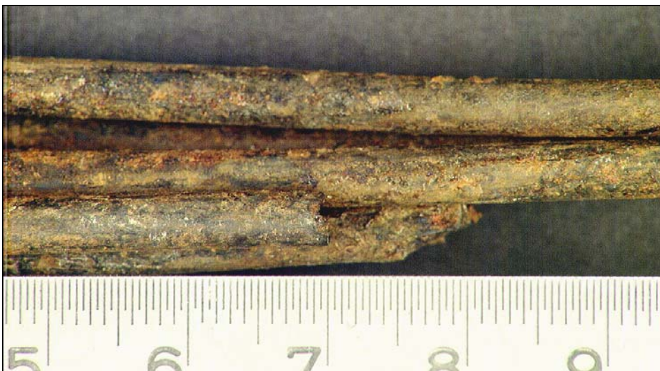
Bild 9: Detail aus Bild 8 , Bruchbereich.
