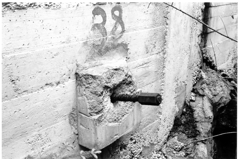
Bild 1: Durch Ankerbruch weg gesprengter Mörtelvorsatz.
