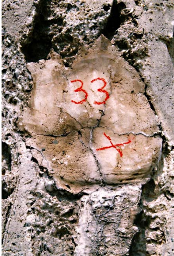
Bild 2: Nischenbeton mit Rissen und Aussinterungen.
