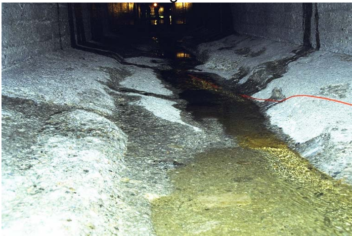
Abbildung 3.5 Schleifend und stossend beanspruchter Betonboden in einem Geschiebeumleitstollen mit kaum Schäden an den Wänden
