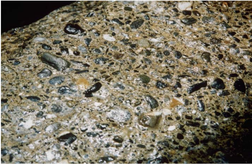
Abbildung 3.1: oberflächlicher Verschleiss („Waschbeton“) an Beton mit einem Grösstkorn von 32 mm an einer Wehrkrone
