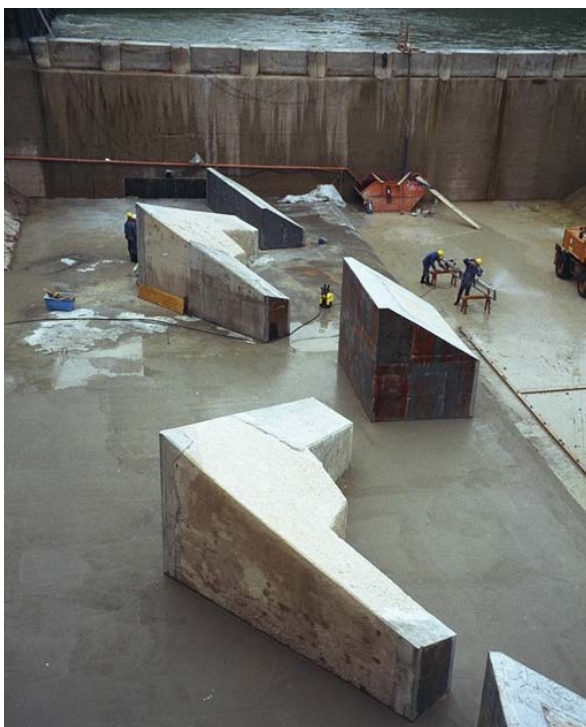
Abbildung 3.2: Mit Stahlblechen und Hochleistungsbeton instandgesetztes Tosbecken; die Schäden traten infolge ungünstiger Strömungsbedingungen auf; das Wasser zirkuliert mit relativ hoher Geschwindigkeit im Tosbecken, wobei die maximale Geschiebegrosse nur wenige Zentimeter beträgt;
