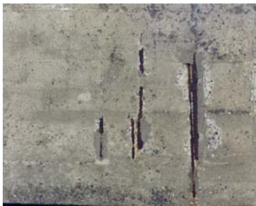
Abbildung 1: Abplatzungen über korrodierenden Bewehrungsstäben an einer Fassade infolge Karbonatisierung des Betons.
