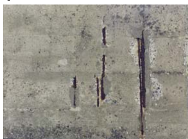
Figure 1 : éclatements au-dessus des barres d'armature corrodées d'une façade suite à la carbonatation du béton.
