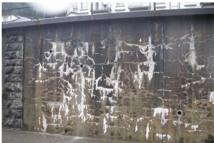
Figure 3: Faïençage caractéristique de la RAG sur un mur de soutènement.
